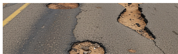
A deterioração das estradas na região da CEDEAO.
