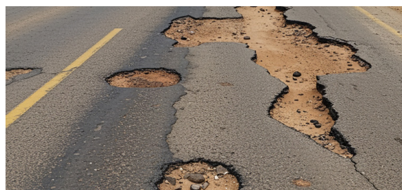
La dégradation des routes dans la région de la CEDEAO.
