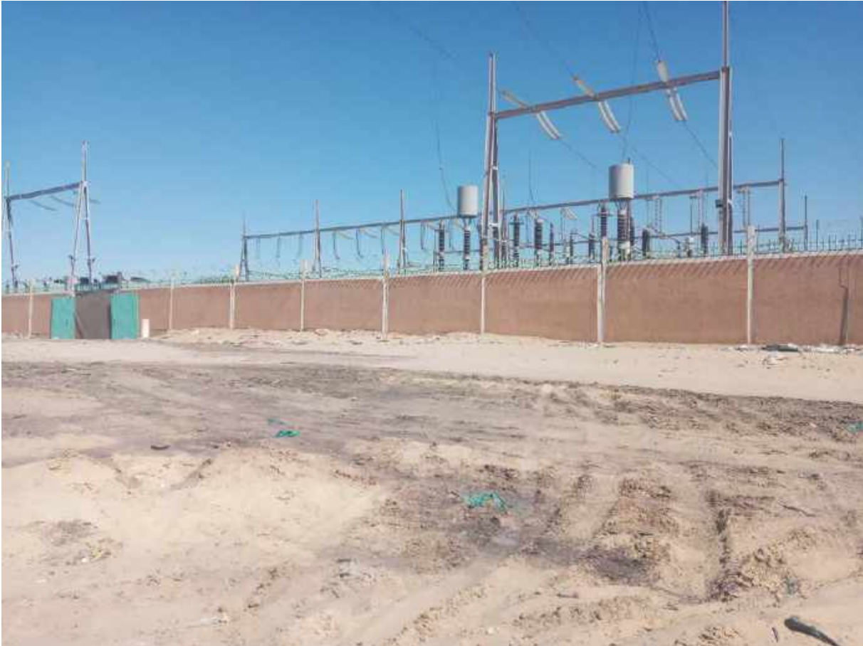
PHOTO : Centrale SOMELEC (OMVS) de Nouakchott
