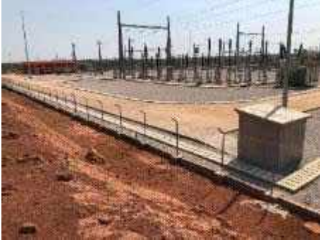
Poste source de Korhogo
