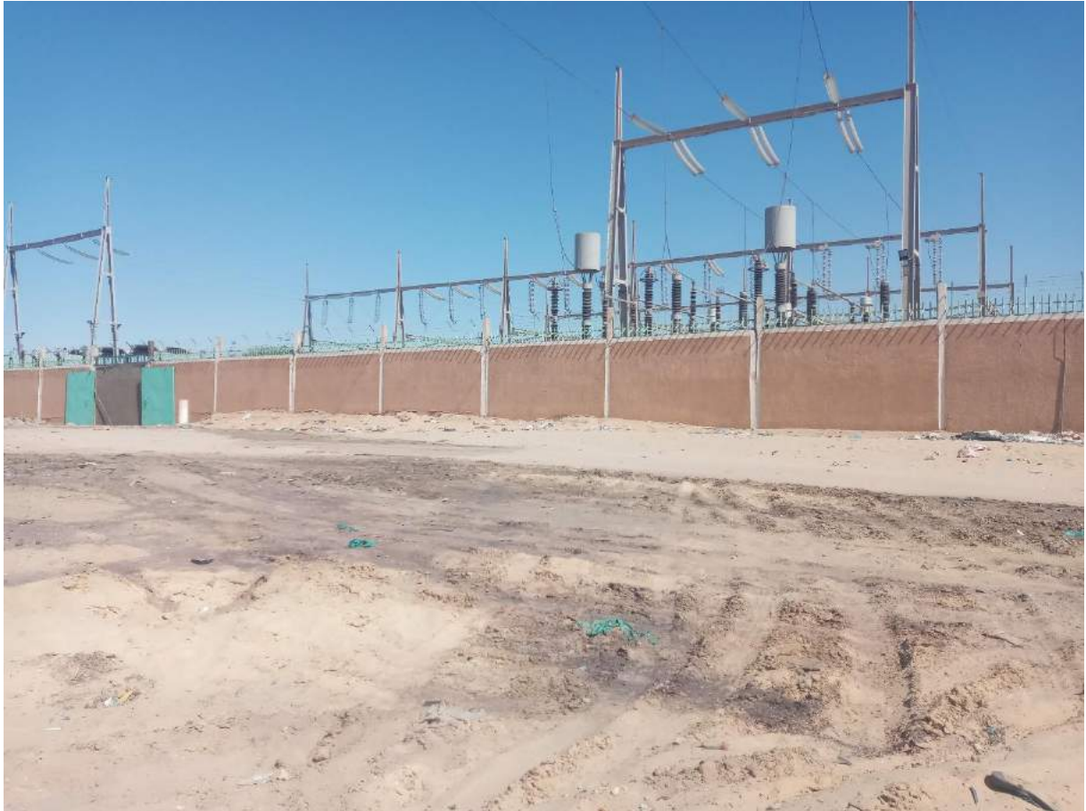
PHOTO : Centrale SOMELEC (OMVS) de Nouakchott : N 18° 02. 657'' / WO 12° 11. 984''
