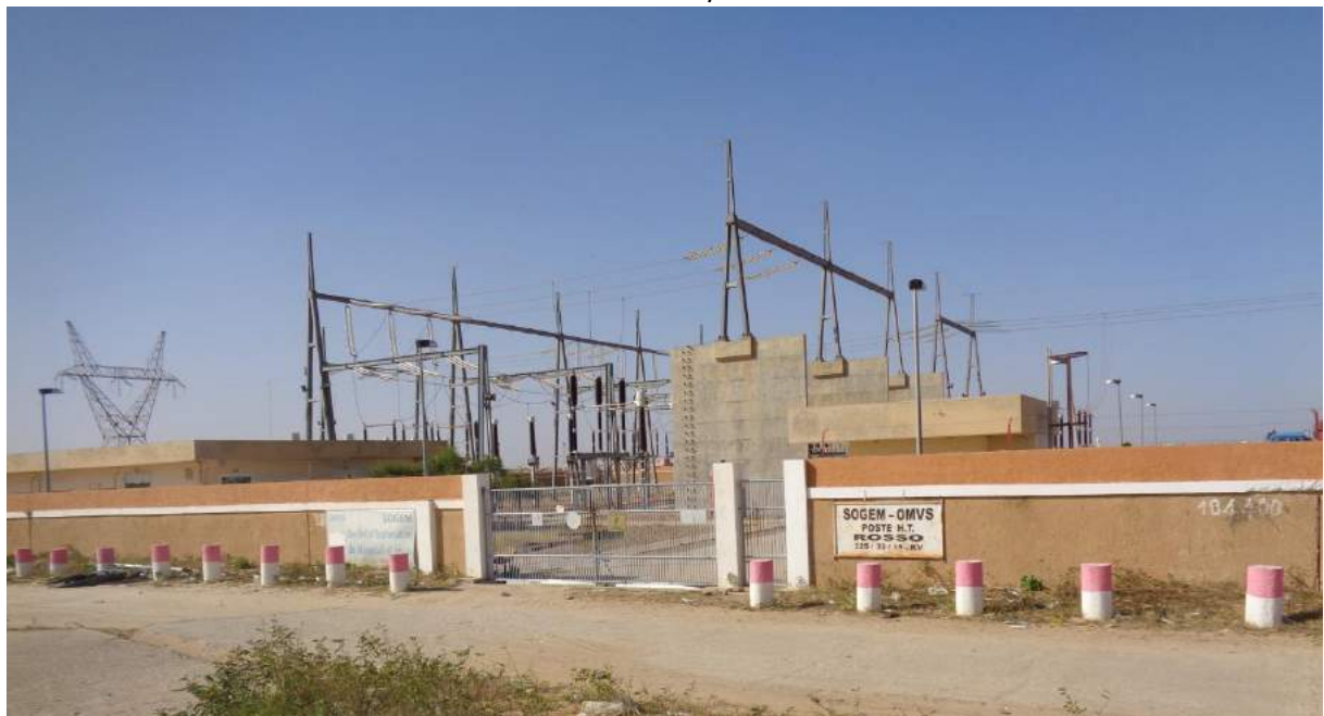
PHOTO : Centrale SOMELEC de Rosso : N 16° 33. 925'' / WO 15° 49. 354''
