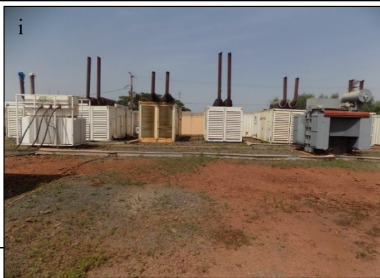
Stockage d'énergie), présence de groupes électrogènes
